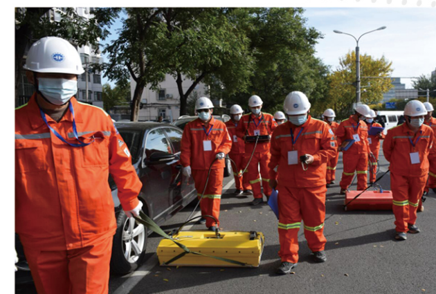
首都城市道路病害隐患探测
